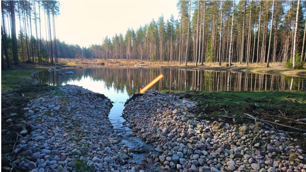
Bild 5. Bräddavlopp med stålplåt
